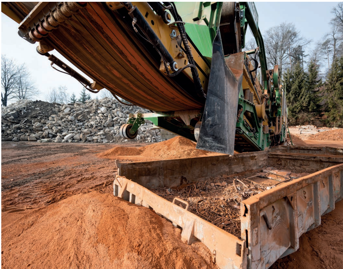
Die Aufbereitungsanlage wird von einer Partnerfirma im Auftrag der Bereuter AG direkt vor Ort betrieben.
